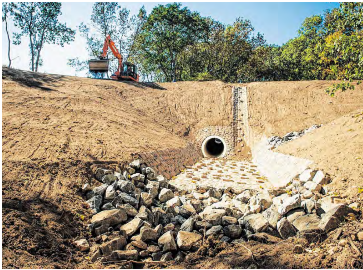
Die alte Naturstein-Gewölbebrücke zwischen Naumburg und Neidschütz ist passé. Ersetzt wurde sie durch einen Stahlbeton-Rohr-Durchlass. An der Asphaltstraße darüber wird noch bis Ende September gearbeitet. FOTOS (2): TORSTEN BIEL
